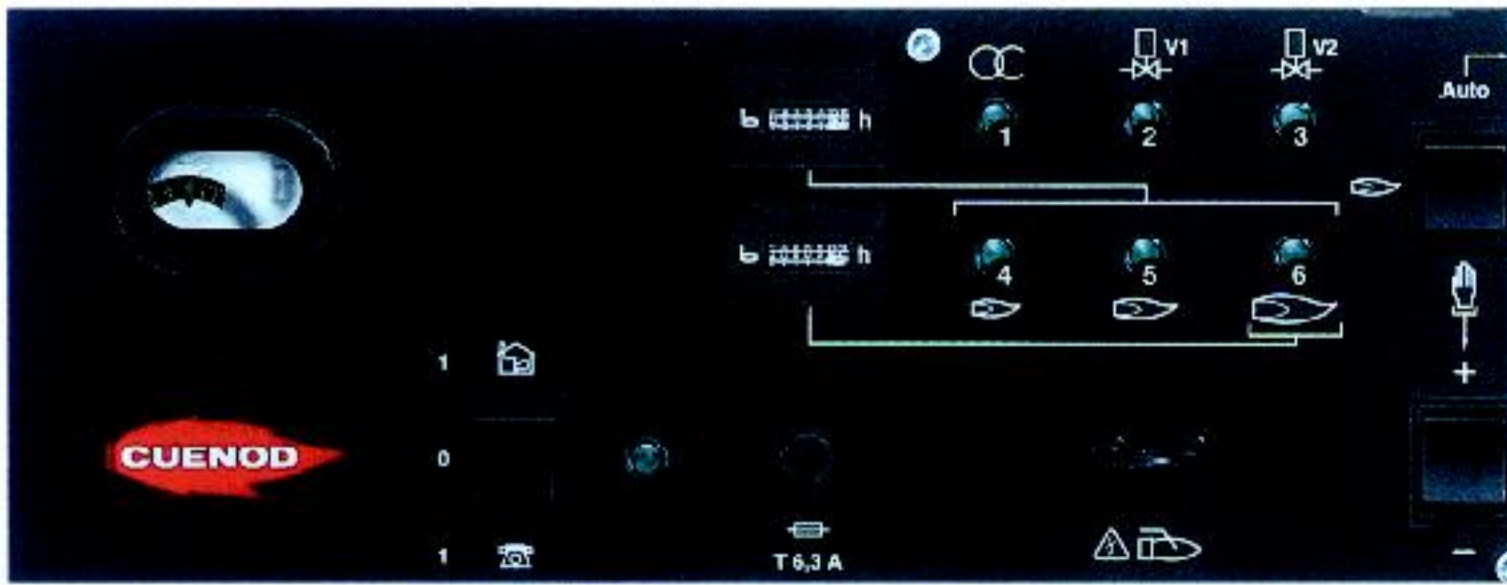
Brülör Elektrik tablo gösterge bilgileri
